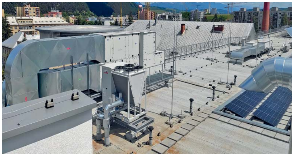
Pohľad na zariadenie na streche objektu.
