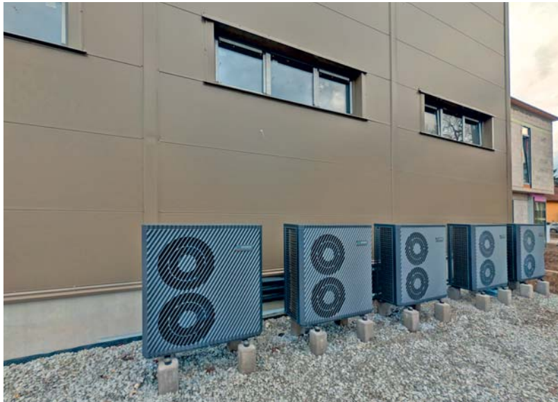
MSI Forming – výrobná hala – kaskádové zapojenie
