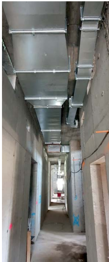
Rozvody vzduchotechniky v Centru důstojného stáří.
