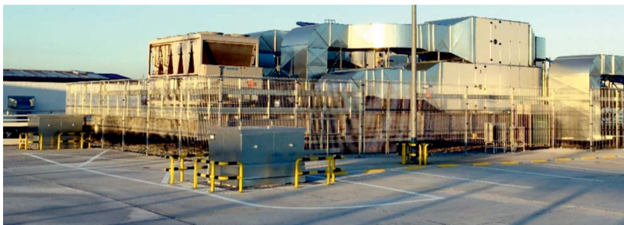
Vzduchotechnické jednotky jsou umístěny na střeše komplexu.
