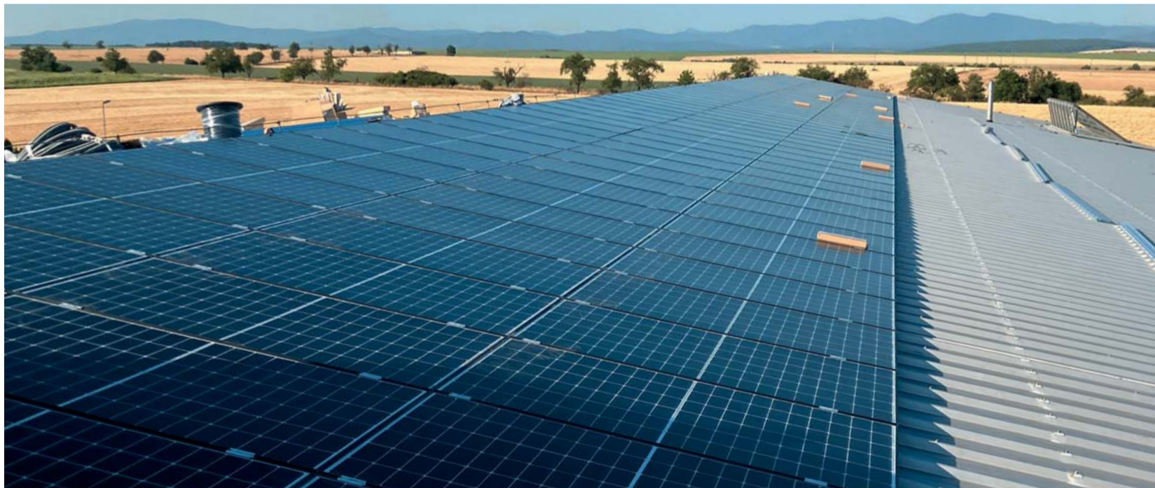
Fotovoltaická elektrárňa o výkone 99,9kW dodáva energiu spoločnosti Arnold izolácie.
