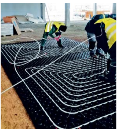
Výroba klíma modulov priamo na stavbe v Trnave, takto bolo vyrobených 324 ks.
