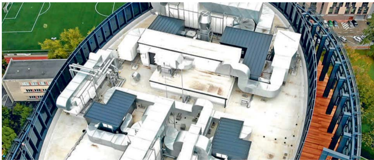
Národný futbalový štadión v Bratislave, pohľad na strojovňu VZT na streche administratívnej budovy.
